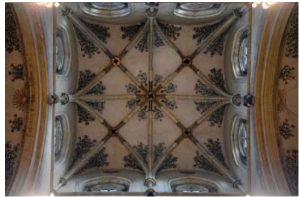
39 Liebfrauen Trier, Quadratur und Aureole der Vierung; das transversal gedrehte, innere Kreuzgewölbe schwebt auf seitlichen Konsolen über den Scheitelpunkten der Vierungsbögen
