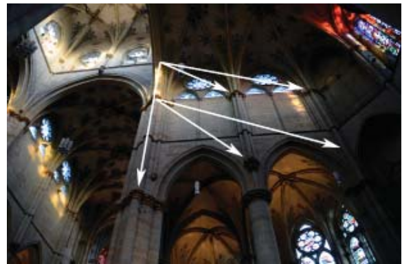
8 Liebfrauen Trier, Arkaden und teilweise geöffnete Obergadenfenster als wandhafte ‚Strebebrücken‘ zur Absicherung der resultierenden Seitenschübe (Pfeile) der großen Vierungsbögen und des gewölbten Vierungsturms
